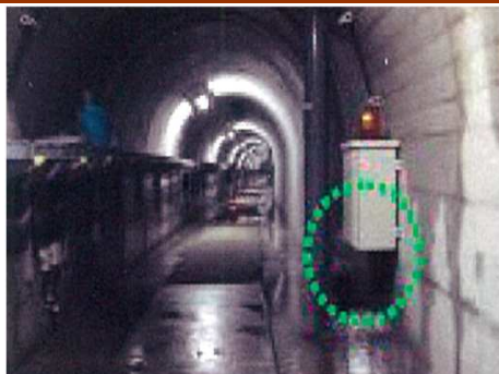
トンネル内非常電話ボックス
